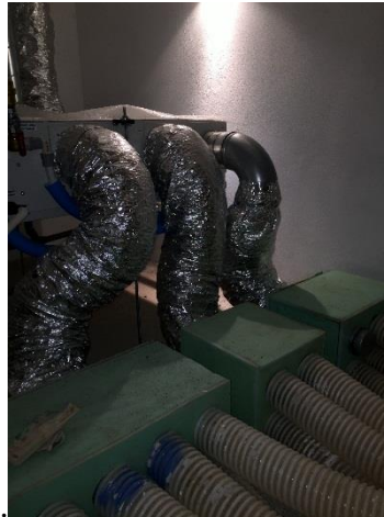
Figura 4 - Coibentazione incompleta dei canali e una doppia curva appena dopo la macchina: forte perdita di carico e perdita di energia
