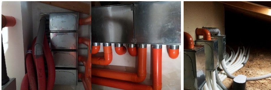
Figura 7 - Usa serie di gravissimi errori: materiali non idonei, assenza di coibentazione, mancanza totale di tenuta dei giunti, impossibilità di identificazione dei condotti: peggio non si poteva fare
