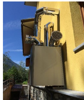
Figura 2 - Un recuperatore da interno montato all'esterno e assenza di raccordi antivibranti e silenziatori: 3 gravi errori in un'unica realizzazione
