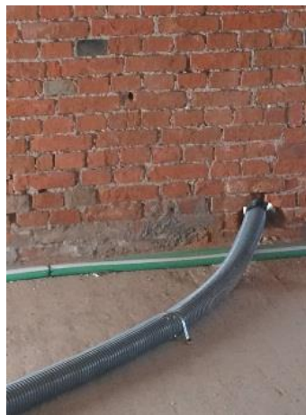
Figura 6 - Se i tubi dell'ACS sono coibentati, perché quelli dell'aria no?
