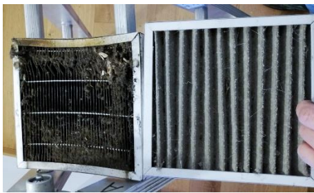
Figura 10 - Filtri andati ampiamente oltre la scadenza
