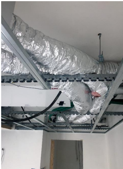
Figura 3- Impianto completamente realizzato con tubo flessibile isolato - Forti perdite di carico e impossibilità di pulizia
