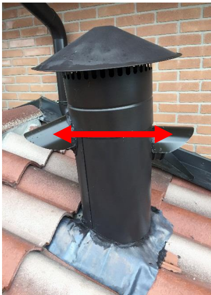
Figura 5- Presa aria ed espulsione a pochi centimetri l'uno dall'altro - Rischio concreto di cortocircuito
